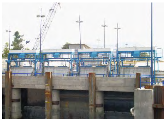
PLANTA DE BOMBEO GRAN CANAL KM 11+600
