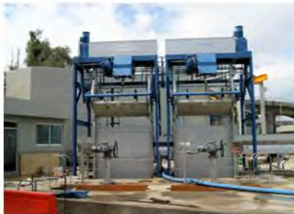
PLANTA DE BOMBEO MUYUGUARDA MÉXICO D.F.
