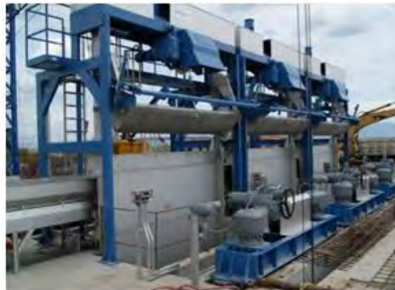
PLANTA DE BOMBEO CASA COLORADA PROFUNDA
